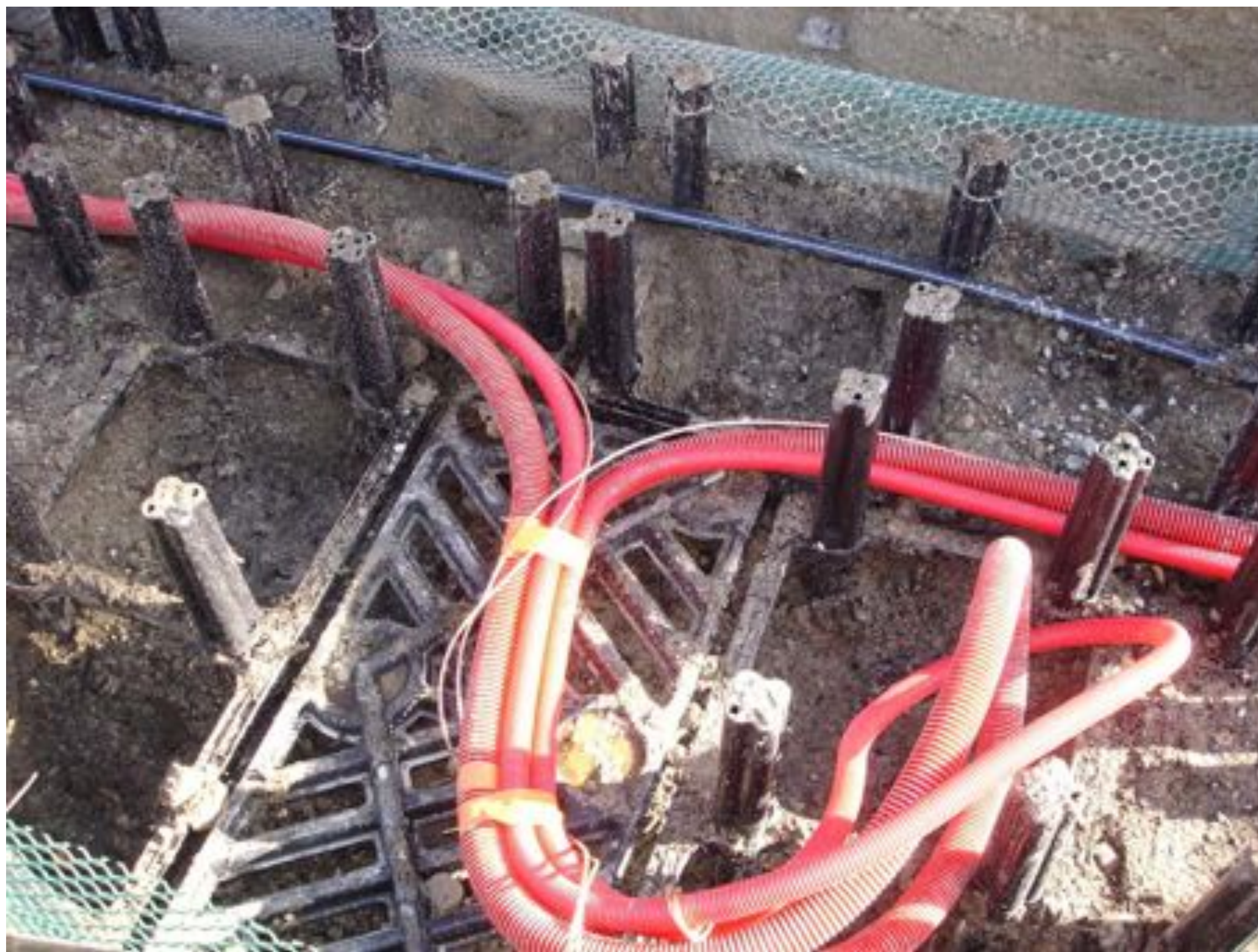
Passage des réseaux
